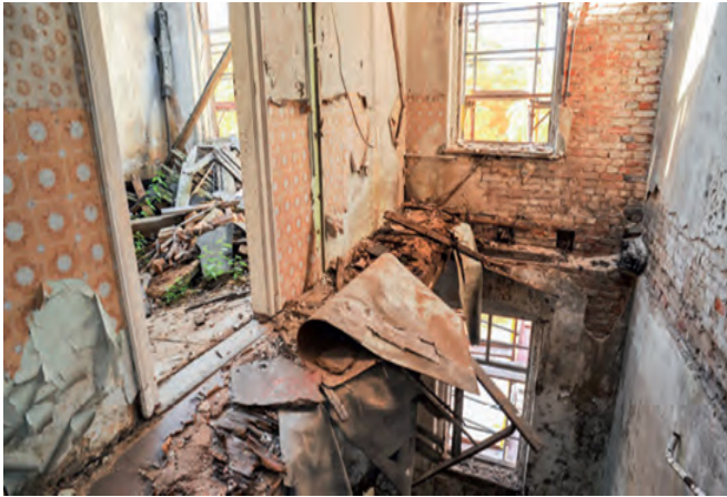
Abbildung 9: Gebäudezustand verschiedener Liegenschaften
